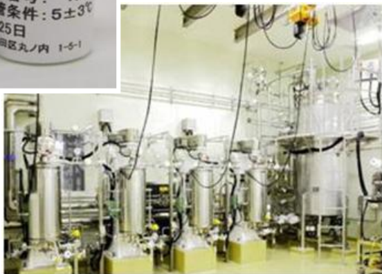
バイオ医薬品設備
