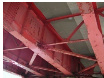
ルミフロン® 未塗布の橋脚（16年目）
