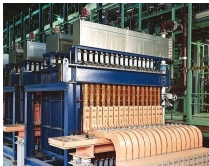
AGCのイオン交換膜（フレモン膜）が 使用されている電解槽設備
