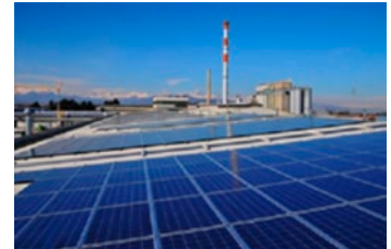
クネオ工場の太陽光パネル
